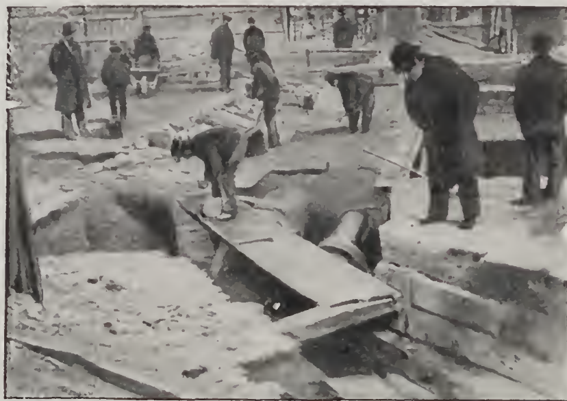
Déplacement des conduites d'eau et de gaz, sur le passage de la nouvelle ligne.
